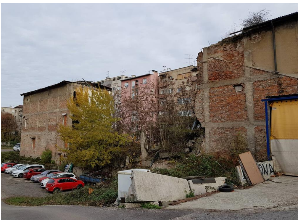
Fotografija 3: Urušeni dio dvorišne zgrade(2018.g), Izvor:Autor
