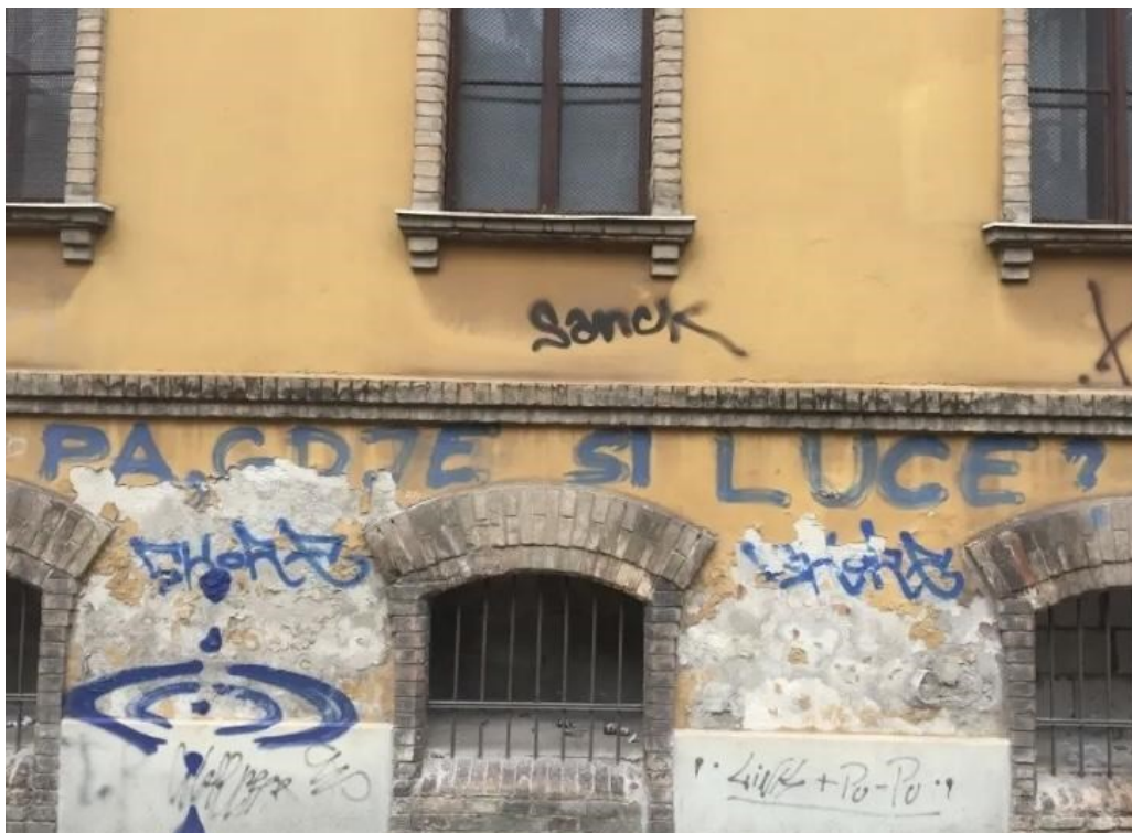
Slika 40.: Oštećenja na uličnom pročelju
