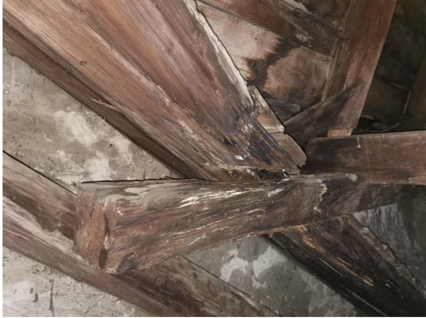
Slika 39.: Prikaz oštećene drvene konstrukcije u dijelu zapadne male kupole
