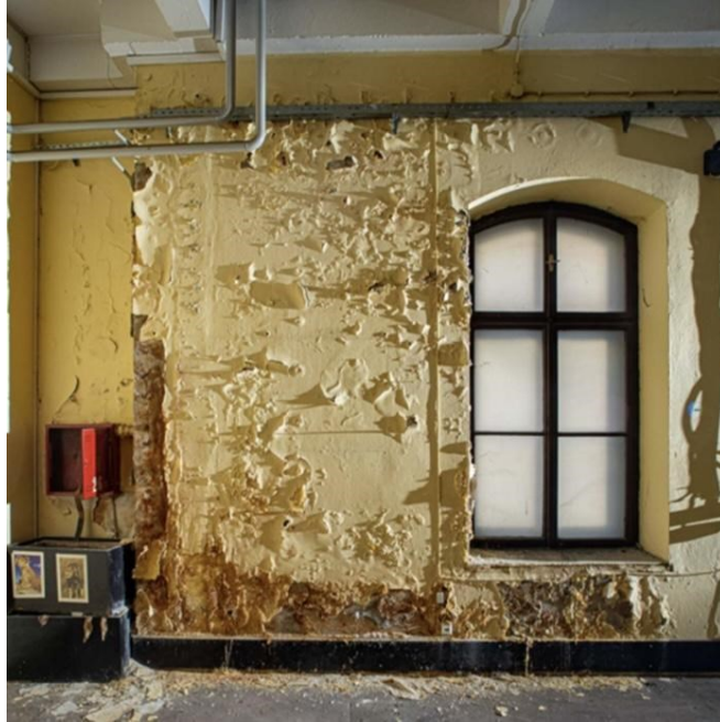
Slika 36.: Prikaz prisutnosti vlage i opadanja žbuke na zidu drugoga kata
