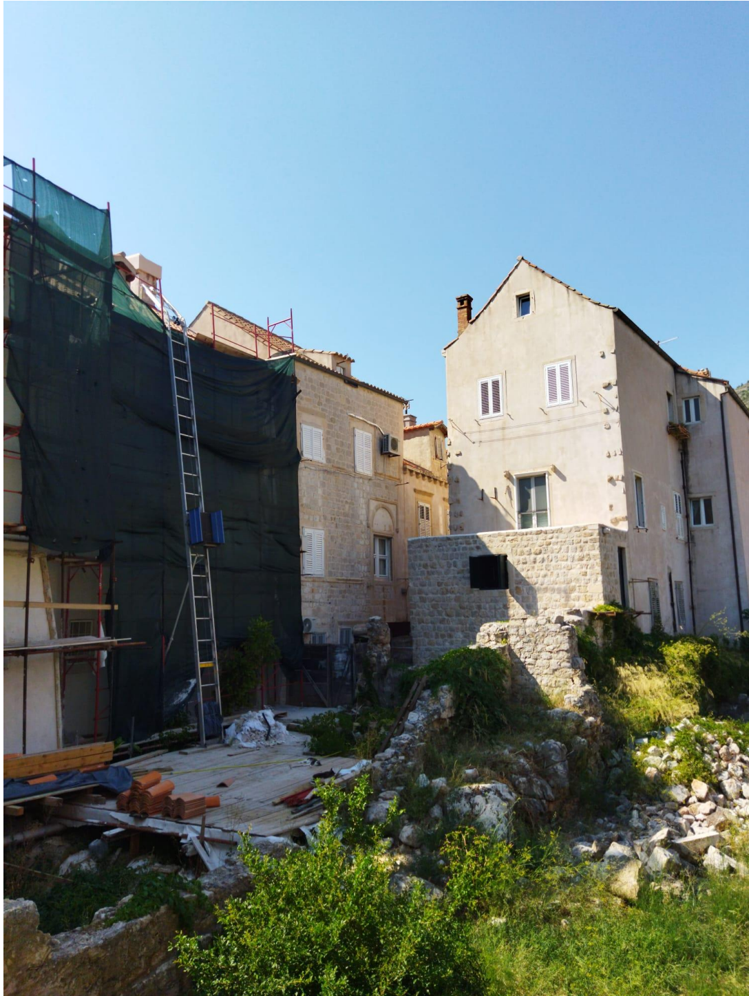
Slika 4: Pogled na Bandurevu 6 (zgrada desno od skele s četiri prozora) od strane bastiona Svetog Spasitelja - foto: Matej Lisičić 22. 8. 2023.
