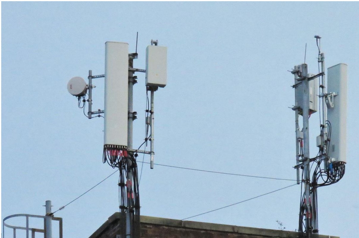
Slika 3. 5G bazna stanica, Izvor: https://mreza.bug.hr/huawei-najveci-dobavljac-5g-baznih-stanica/
