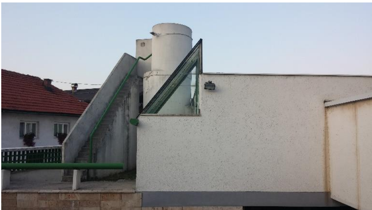
Kat. I. Sl. 10. Oštećenja na zidu, (2016.).
