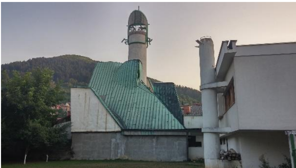
Kat. I. Sl. 7. Zelena limena oplata na krovu, (2016.).
