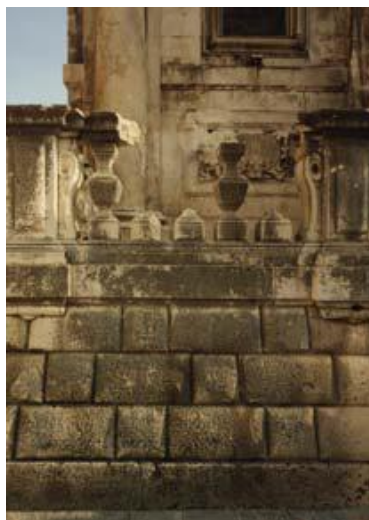
Slika 36. Oštećena ograda na crkvi sv. Vlaha
