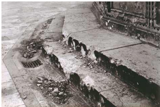
Slika 47. Detalj oštećenja stepenica na sjevernom dijelu fontane uzrokovanih gelerima, prosinac 1991.
