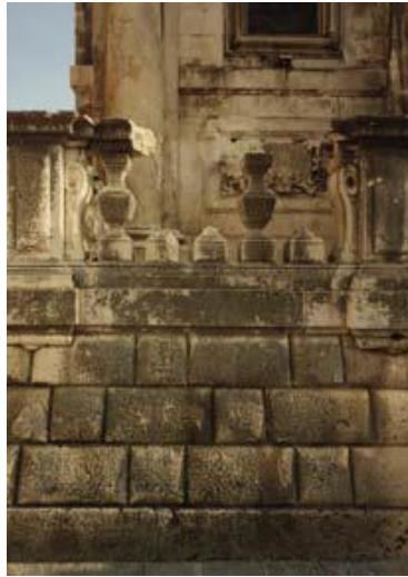
Slika 36. Oštećena ograda na crkvi sv. Vlaha
