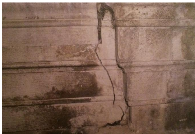
Slika 39. Pukotine i oštećenja kamenog zida
