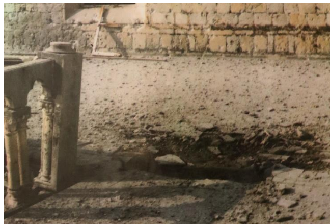
Slika 26. Teško oštećenje terase i ograde
