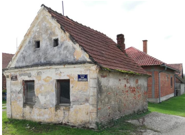
Slika 43. Zapuštена zidanica iza koje je izgrađena nova kuća, Ulica bana Josipa Jelačića, Hlebine (snimila Patricija Andrašić, 26.9.2022.)
