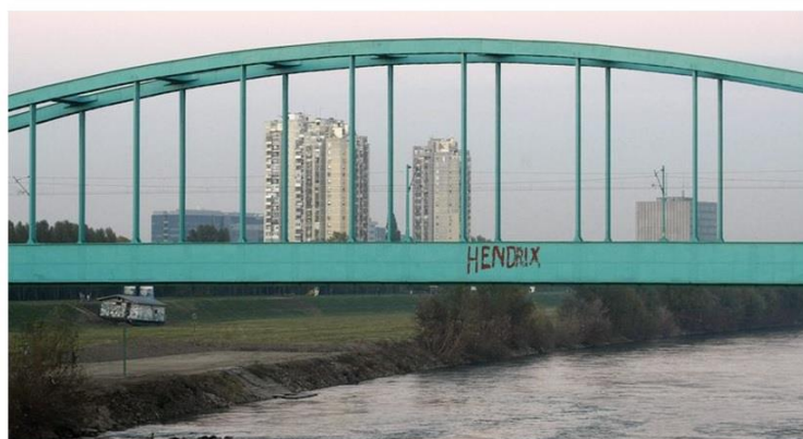
Željeznički Zeleni most, Zagreb, prije obnove.
