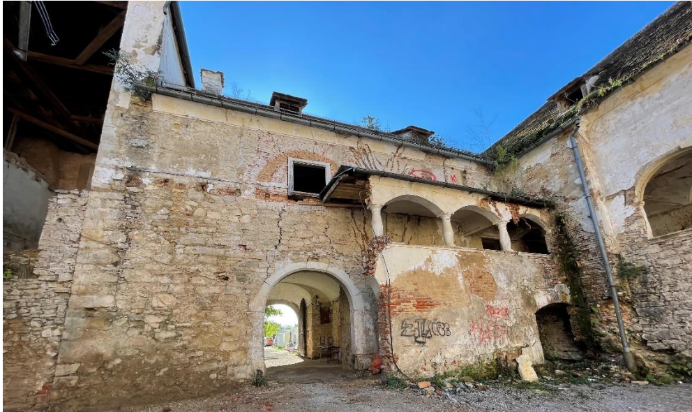
Slika 27. Oštećenja jugoistočnog dvorišnog pročelja
