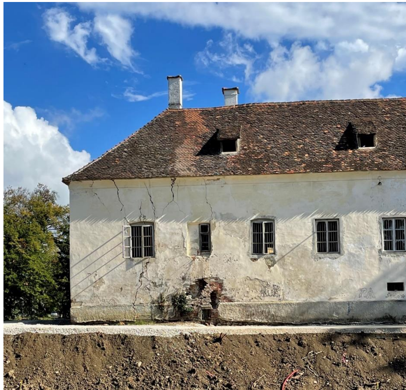
Slika 25. Detalj oštećenja, jugozapadno pročelje
