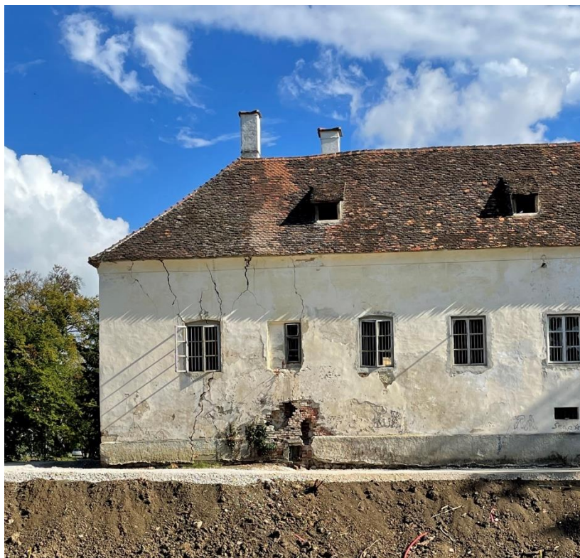
Slika 25. Detalj oštećenja, jugozapadno pročelje
