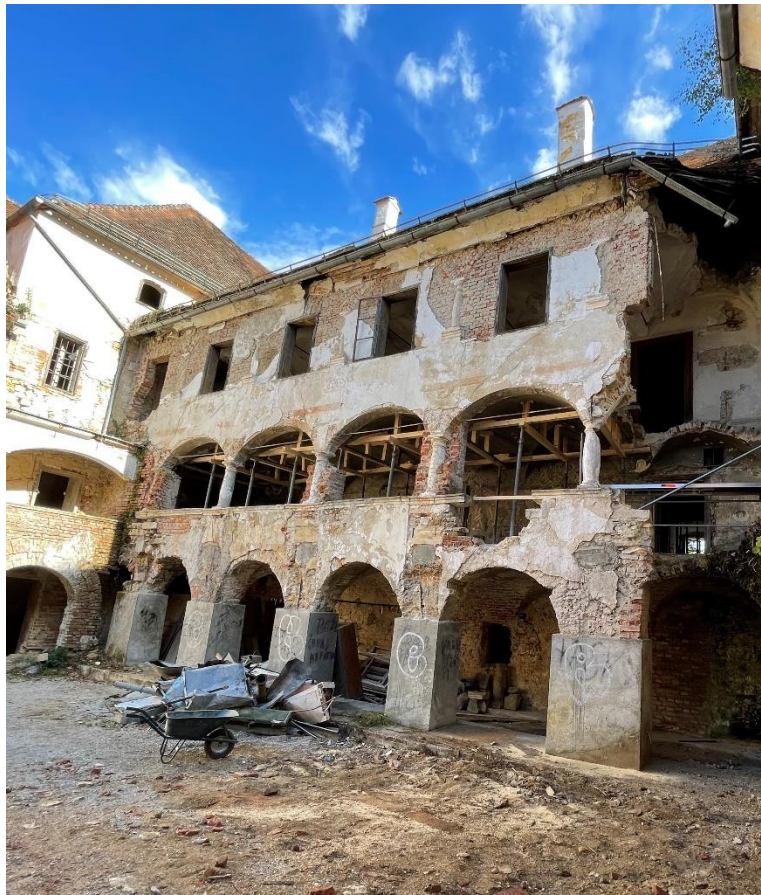
Slika 26. Oštećenje trijema, sjeveroistočno pročelje
