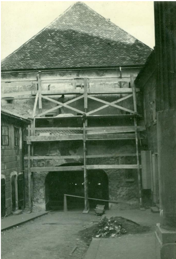
Slika 26. Kamenita vrata – kula: skidanje trule žbuke sa zapadne strane. Desni dio skele ima zaštitni krov od dasaka; snimio Barbarić, 1951. god.; Ministarstvo kulture, inv. br. 9498; neg. /
