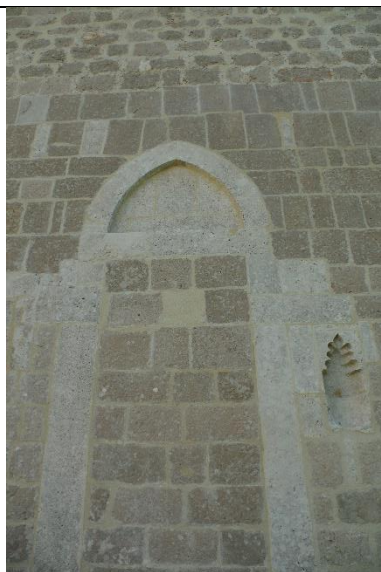
sl.31. Razlika u kamenu sjevernoga pročelja
