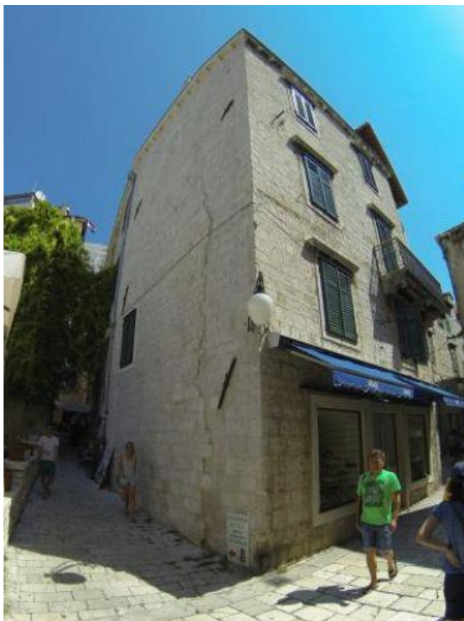
Slika 10. Stanje pročelja prije obnove
