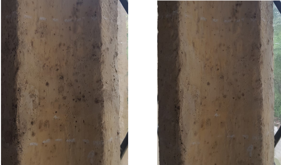
Slika 72 i 73: segment unutrašnje strane stupića bifore zaražene mikroorganizmima, zatečeno stanje i stanje nakon nanošenja Biotina t i mehaničkog čišćenja
