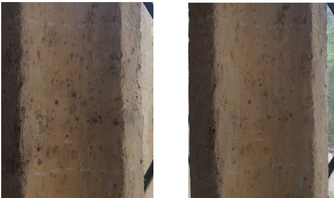
Slika 72 i 73: segment unutrašnje strane stupića bifore zaražene mikroorganizmima, zatečeno stanje i stanje nakon nanošenja Biotina t i mehaničkog čišćenja
