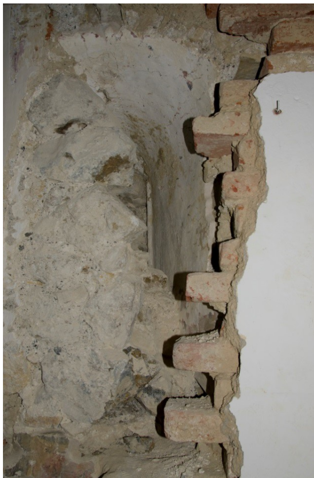
Slika 38: Otkrivena prozorska niša sondiranjem na desnom dijelu južnog zida trećeg traveja
