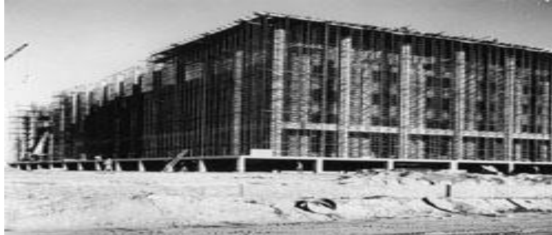
Slika 10: Zgrada NLA u Canberri u izgradnji, lipanj 1966. godine, iz Zbirke slika i fotografija NLA,
