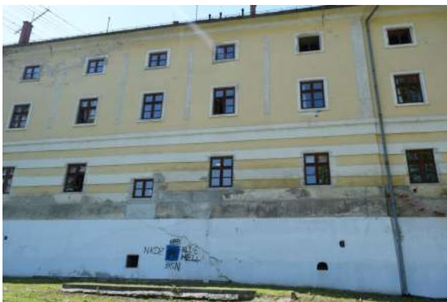
Slika 44. Istočna bočna zgrada sklopa dvorca Batthyány, pogled na istočno pročelje zgrade, vandalizirano u prizemnoj zoni grafitima
