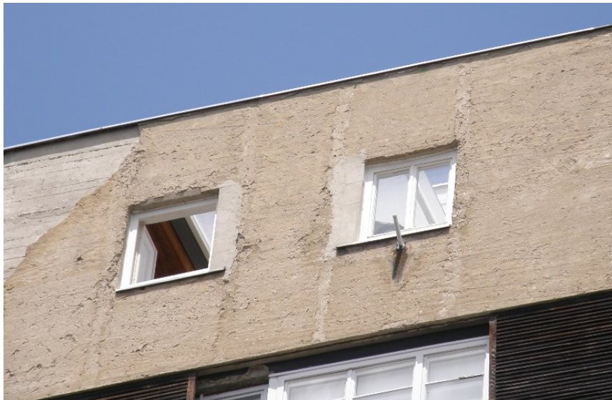
Slika 8. Detalj južnog pročelja i nelegalno ugrađeni prozori na prohodnoj terasi X. kata (2010.)
