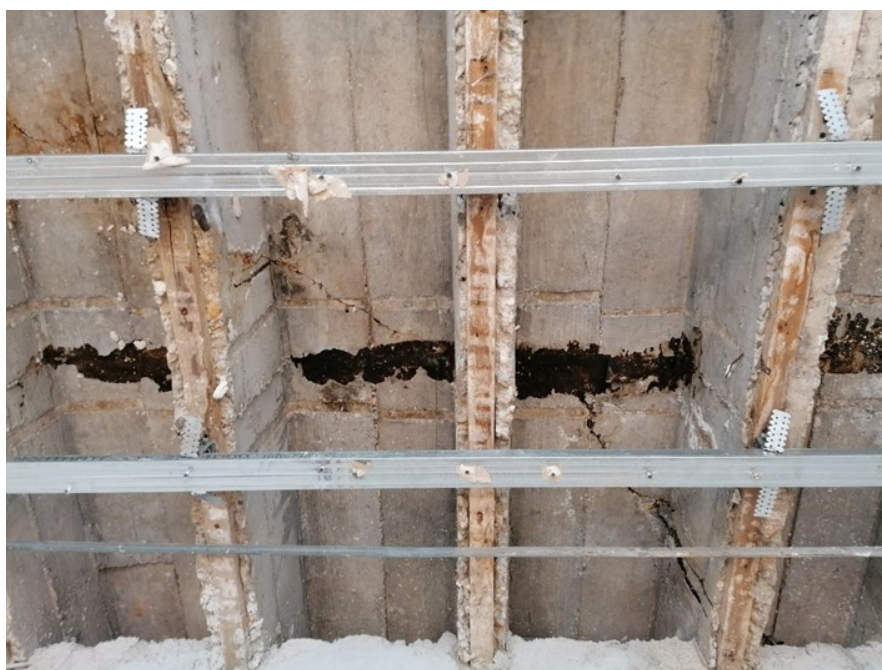
Slika 16. Pukotina na stropnoj konstrukciji, stanje u veljači 2022.
