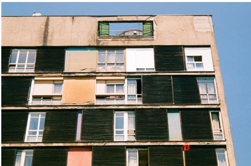
Slika 6. Detalj južnog pročelja nebodera prije obnove (2002. g.)
