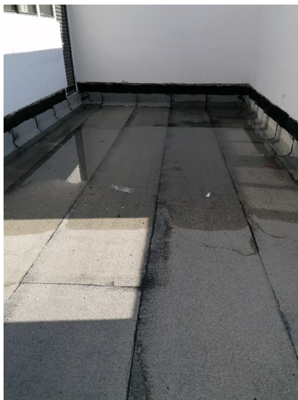
Slika 17. Bitumenski sloj na terasi X. kata, stanje u veljači 2022.
