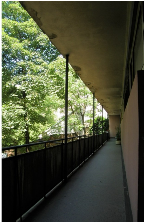
Slika 9. Galerija s ogradom od salonita prije sanacije i obnove (2010.)
