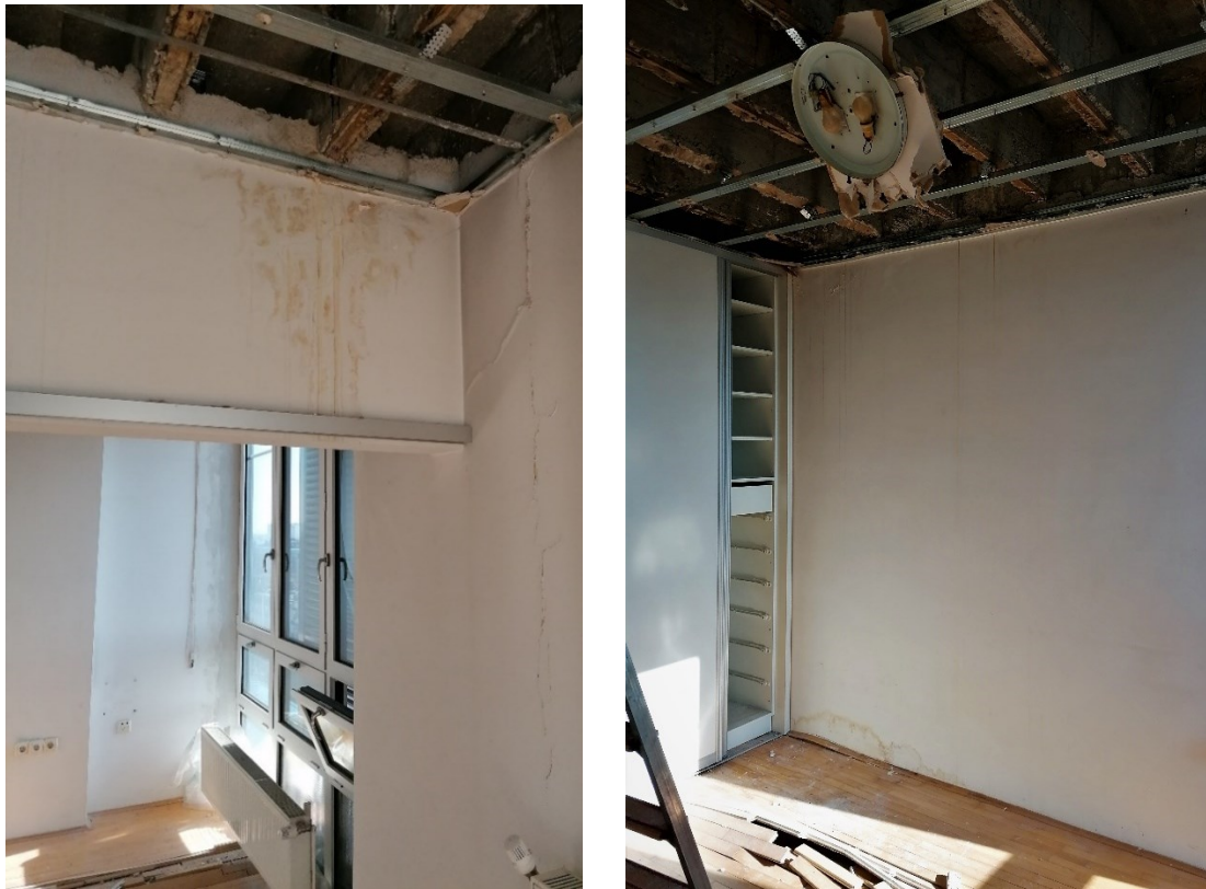
Slika 14.-15. Detalj tragova curenja vode po zidovima i oštećenog parketa, stanje u veljači 2022.
