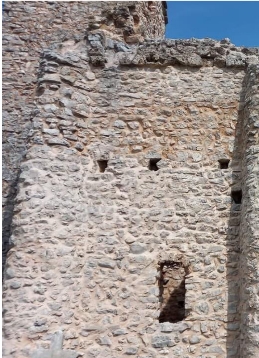
Slika 11. Rupe od drvene skele, detalj na južnom zidu crkve Sv. Spasa. Foto: Jelena Milošević
