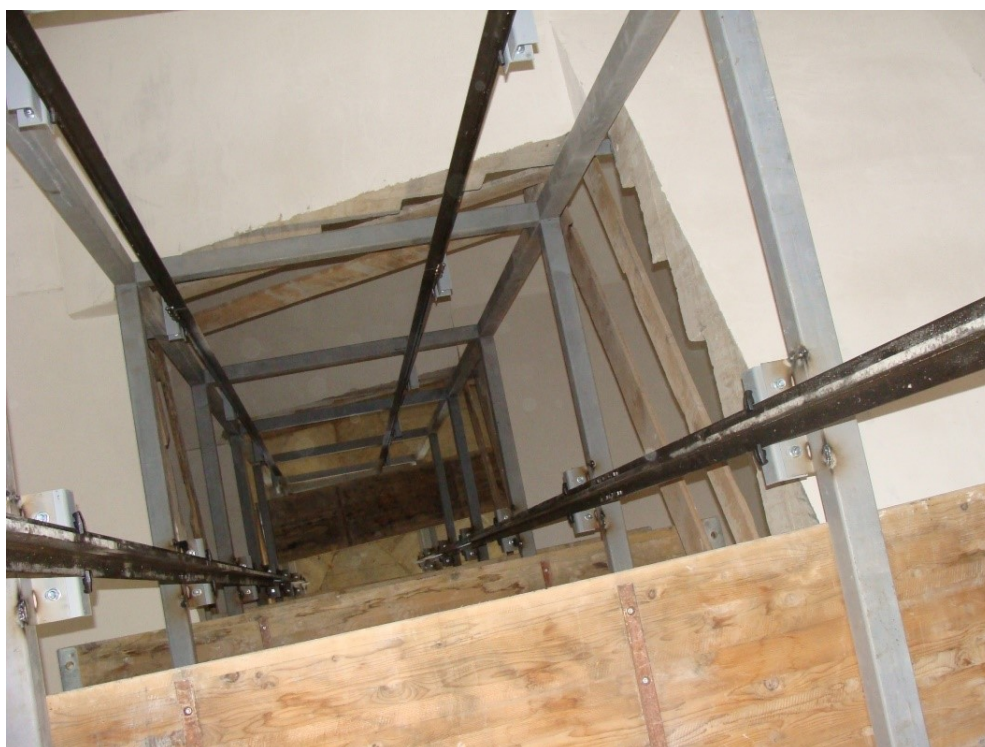
sl. 110. Proces ugradnje lifta unutar centralnog stubišta zgrade bivše uprave i stanovanja duhanske stanice u Metkoviću, danas Prirodoslovnog muzeja i Gradske knjižnice. Fotografirano tijekom obnove zgrade koja je trajala od 2008. do 2015.
