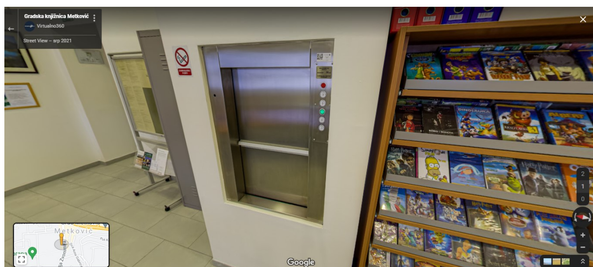
sl. 118. Jedan od ukupno dva tehnička (teretna) lift, snimljen na jednom od katova Gradske knjižnice. Snimljeno u srpnju 2021.
