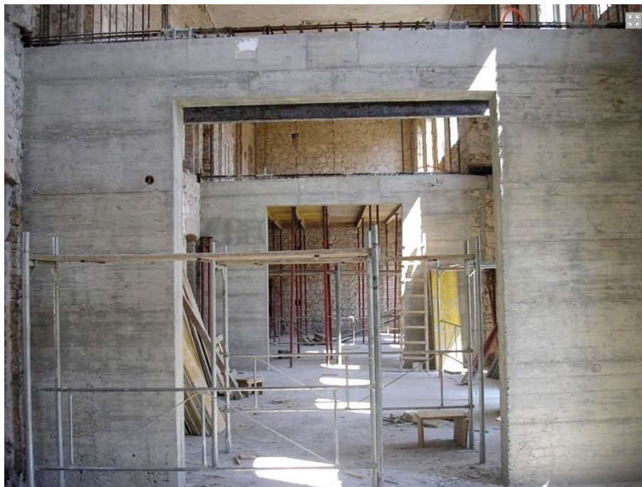
sl. 113. Novi, armiranobetonski i protupotresni nosivi zidovi u unutrašnjosti bivše zgrade uprave i stanovanja i stanovanja duhanske stanice u Metkoviću, danas Prirodoslovnog muzeja i Gradske knjižnice. Fotografirano tijekom obnove zgrade koja je trajala od 2008. do 2015. godine. Na slici je vidljiva i nedostajuća međukatna konstrukcija, koja je uklonjena kako bi se mogla izvesti nova, armiranobetonska
