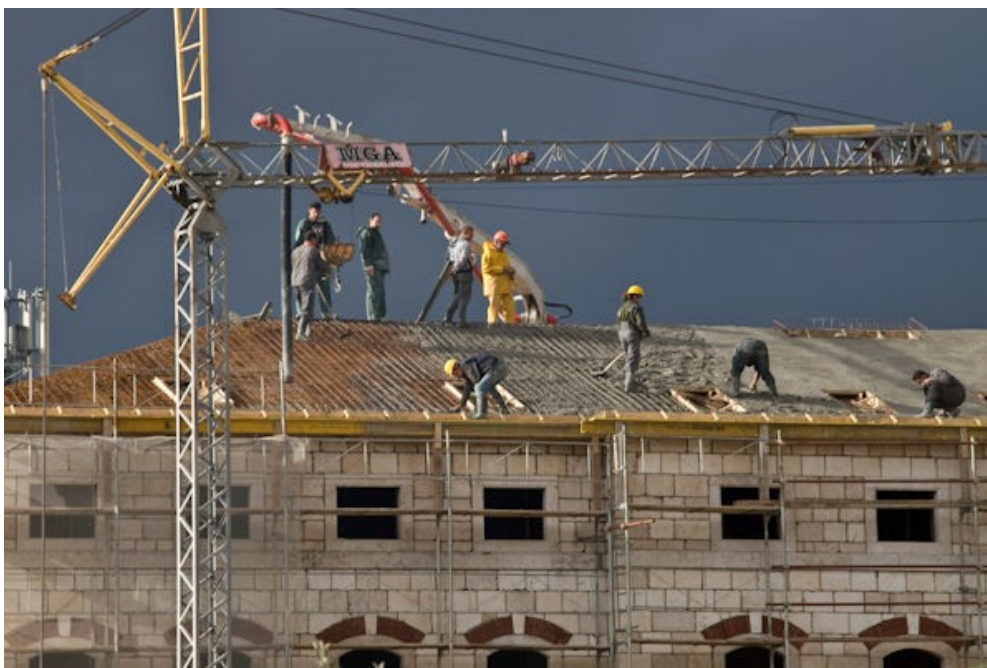
sl. 105. Obnova, odnosno izvedba novog, armiranobetonskog krova bivše zgrade uprave i stanovanja duhanske stanice u Metkoviću, danas Prirodoslovnog muzeja i Gradske knjižnice. Fotografirano tijekom trajanja obnove zgrade u razdoblju od 2008. do 2015. godine
