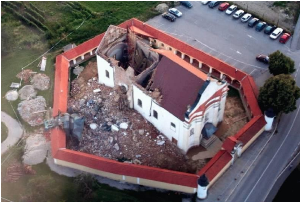
Slika 60. Pogled na urušeni zvonik i crkvu iz zraka (snimljeno 2008.)
