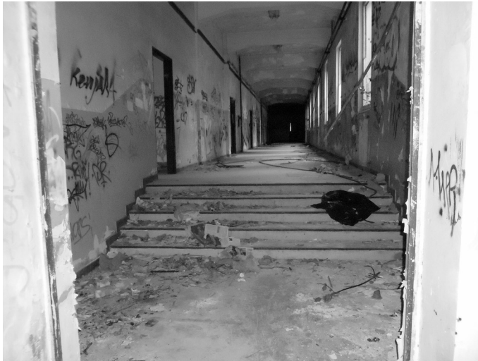
Centar za mlade i proširenje Gradske knjižnice čekaju europski novac, a zgrada propada – unutrašnjost zgrade nekadašnjih spavaonica AŠC-a
