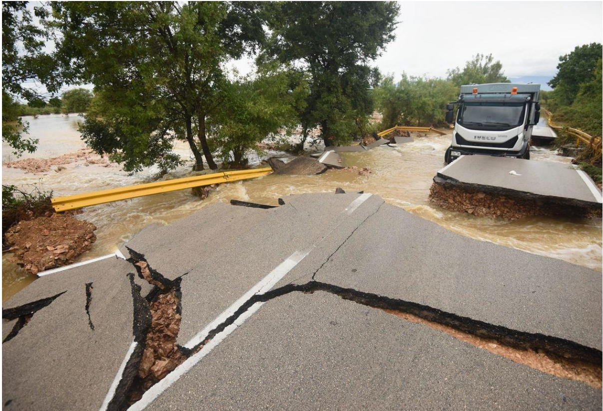
Abbildung 28: Beschädigung der Straße zwischen Zadar und Ražanac am 11. September 2017
