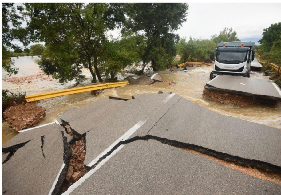
Slika 28 Oštećenje ceste Zadar - Ražanac, 11. rujan 2017. godine
