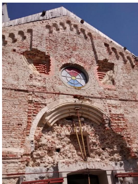
Slika 12. Detalj zapadnog pročelja crkve Sv. Marije Magdalene u Čazmi prije restauratorskih radova
