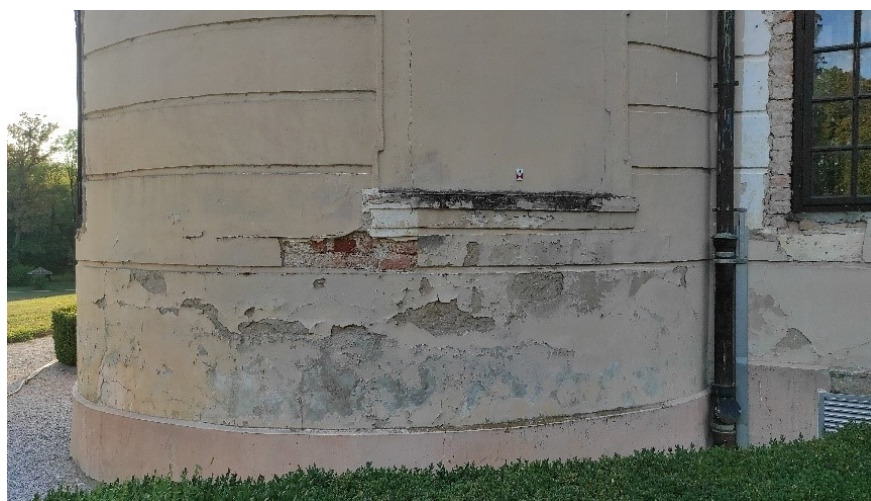
Slika 64 – Oštećenja uzrokovana kapilarnom vlagom, jugoistočna ugaona kula, dvorac Lužnica
