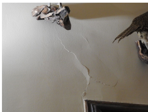
Slika 63 – Pukotine na zidnim površinama u interijeru nastale nakon potresa 28. i 29. prosinca 2020. godine, dvorac Lužnica
