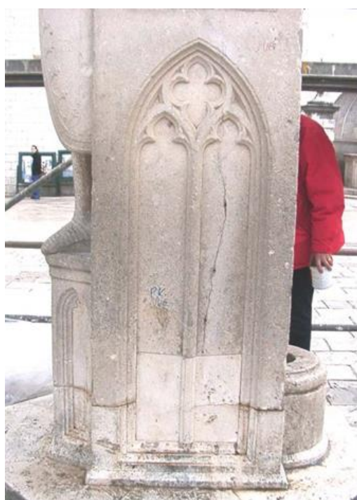
Slika 23. Vertikalna pukotina na zapadnoj strani stupa
