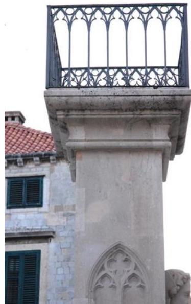
Slika 47. Istočna strana, detalj-tašeli i zakrpe od cementnog morta
