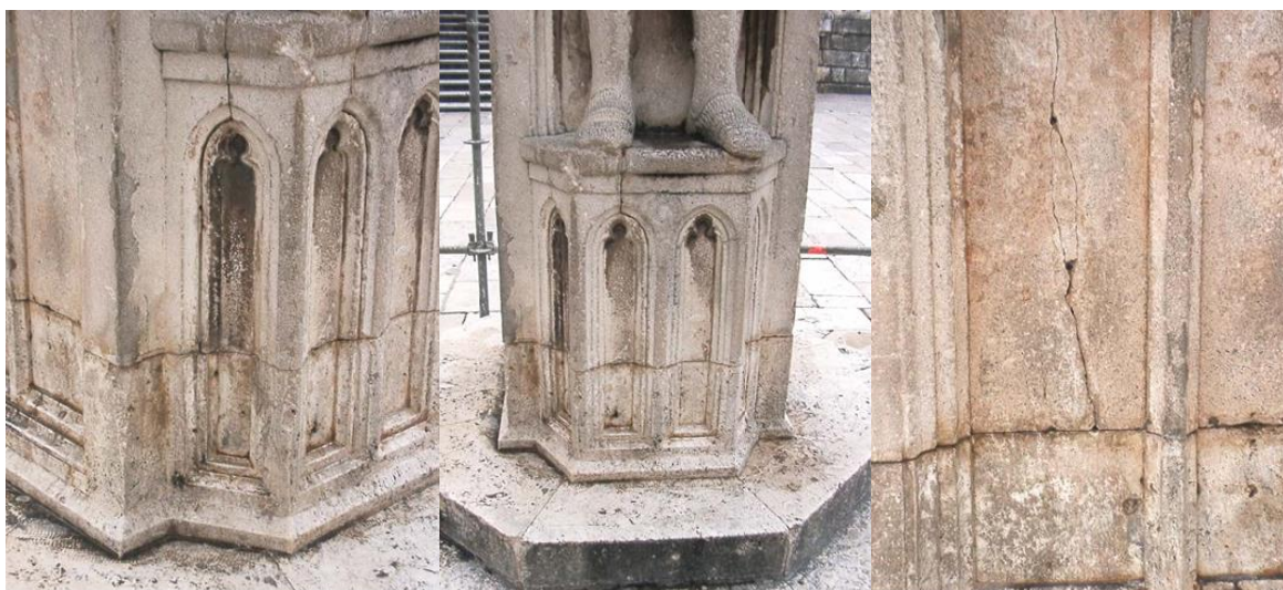
Slike 24, 25, 26. Tragovi hrđe na postamentu Orlandovog stupa
