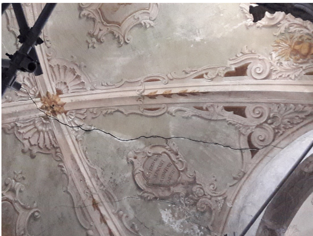
Slika 26. Pukotine na svodu sjevernog broda
