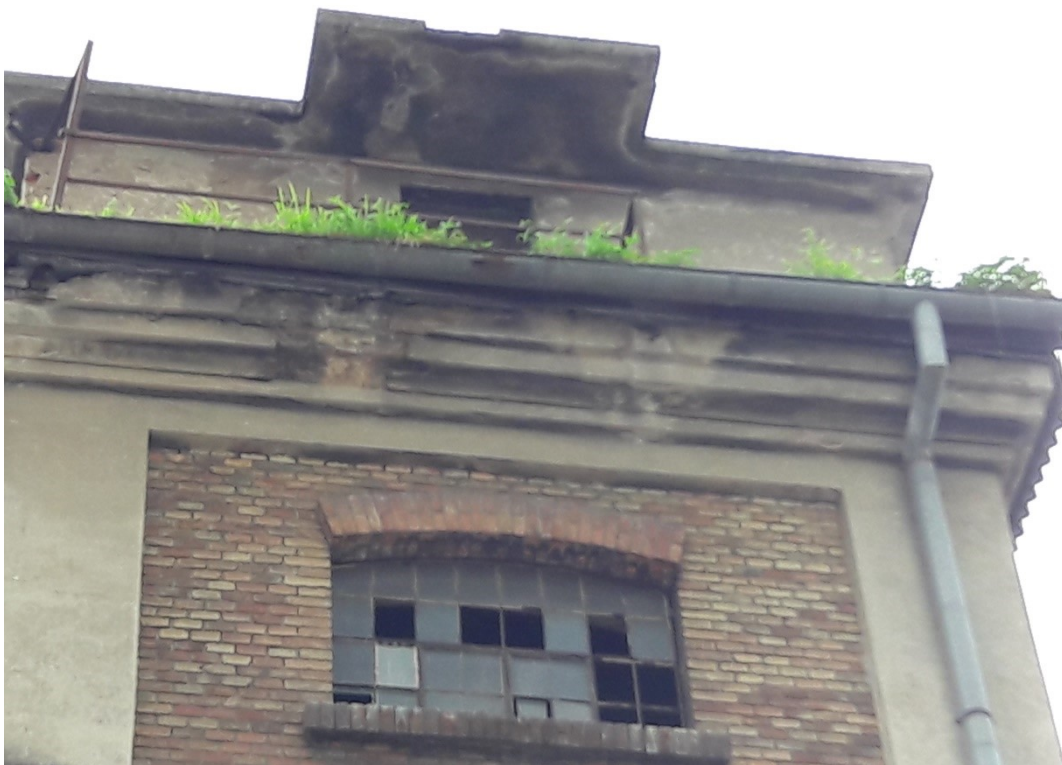
Slika 49. Sjeverozapadni ugao skladišta: neadekvatan sustav odvodnje oborinskih voda i razbijen prozor
