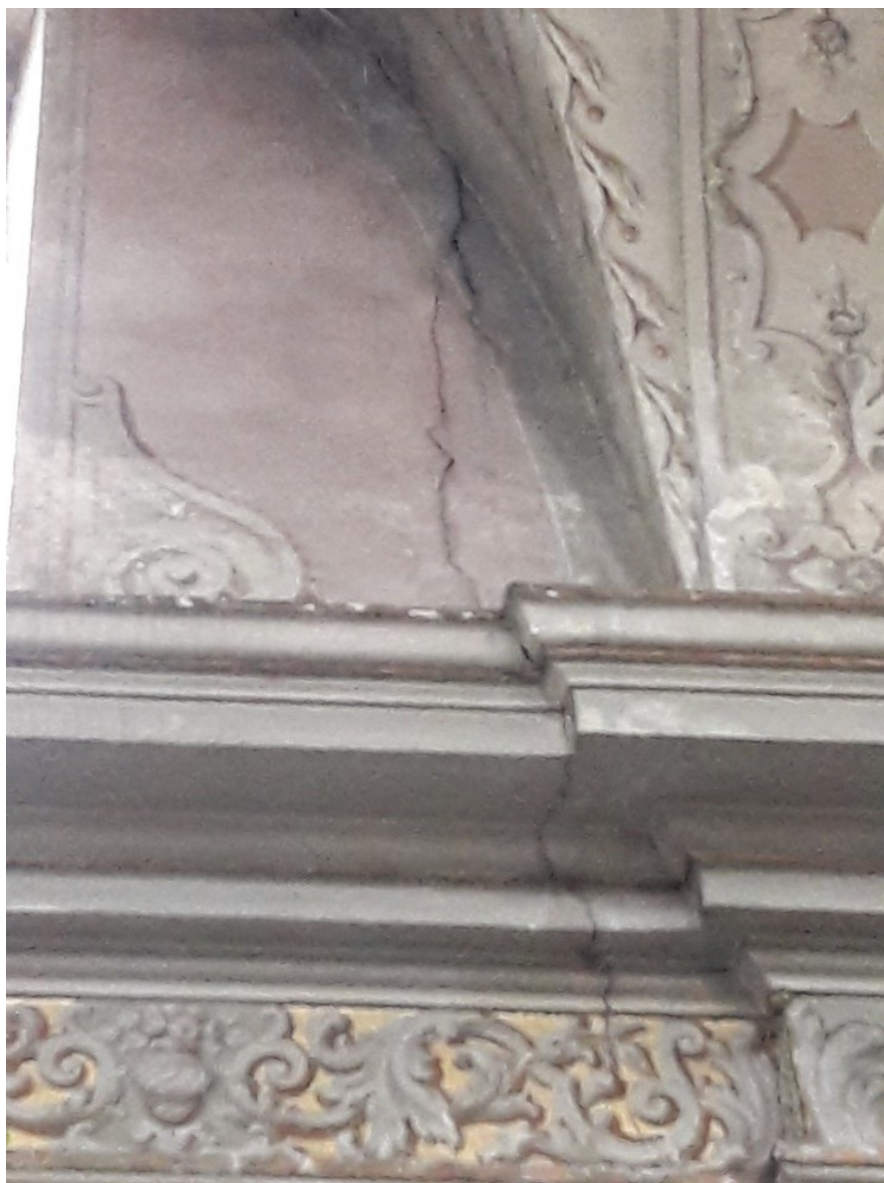
Slika 27. Pukotine na sjevernom zidu glavnog broda
