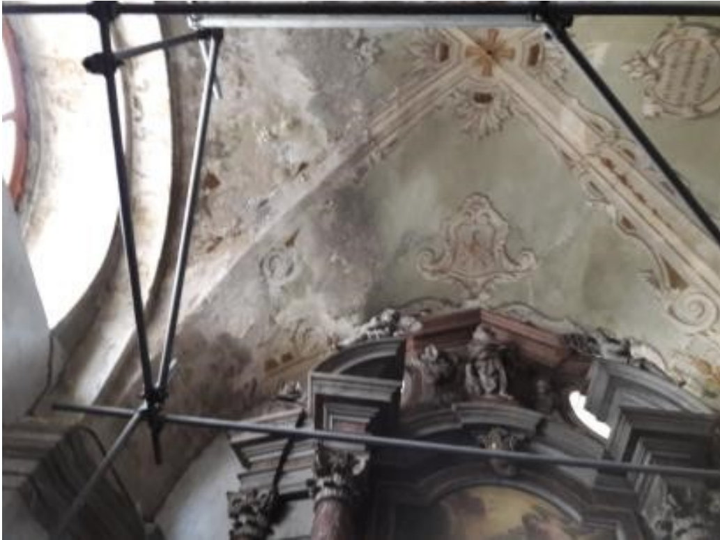
Slika 31. Oštećenja nastala djelovanjem vlage na svodu sjevernog broda
