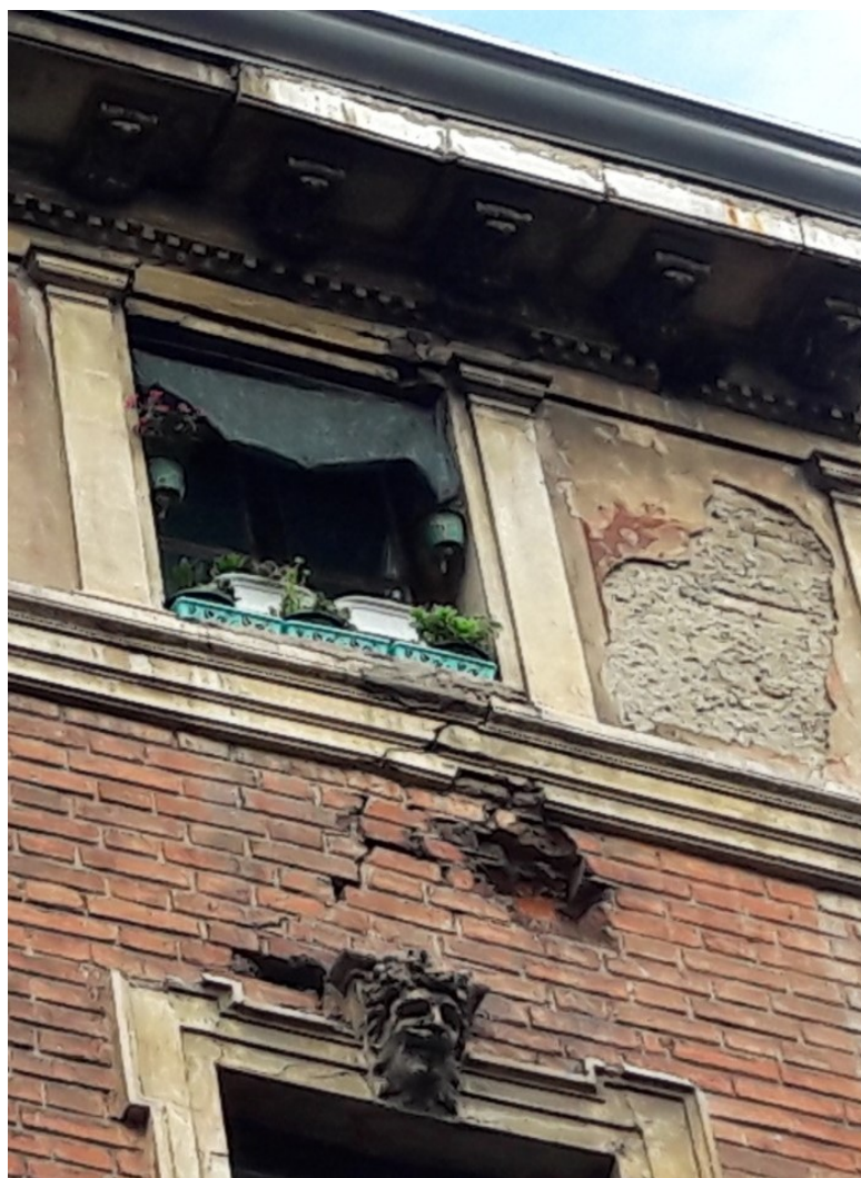
Slika 34. Mehanička oštećenja, oštećenja od vlage i dijagonalna pukotina na južnom pročelju
