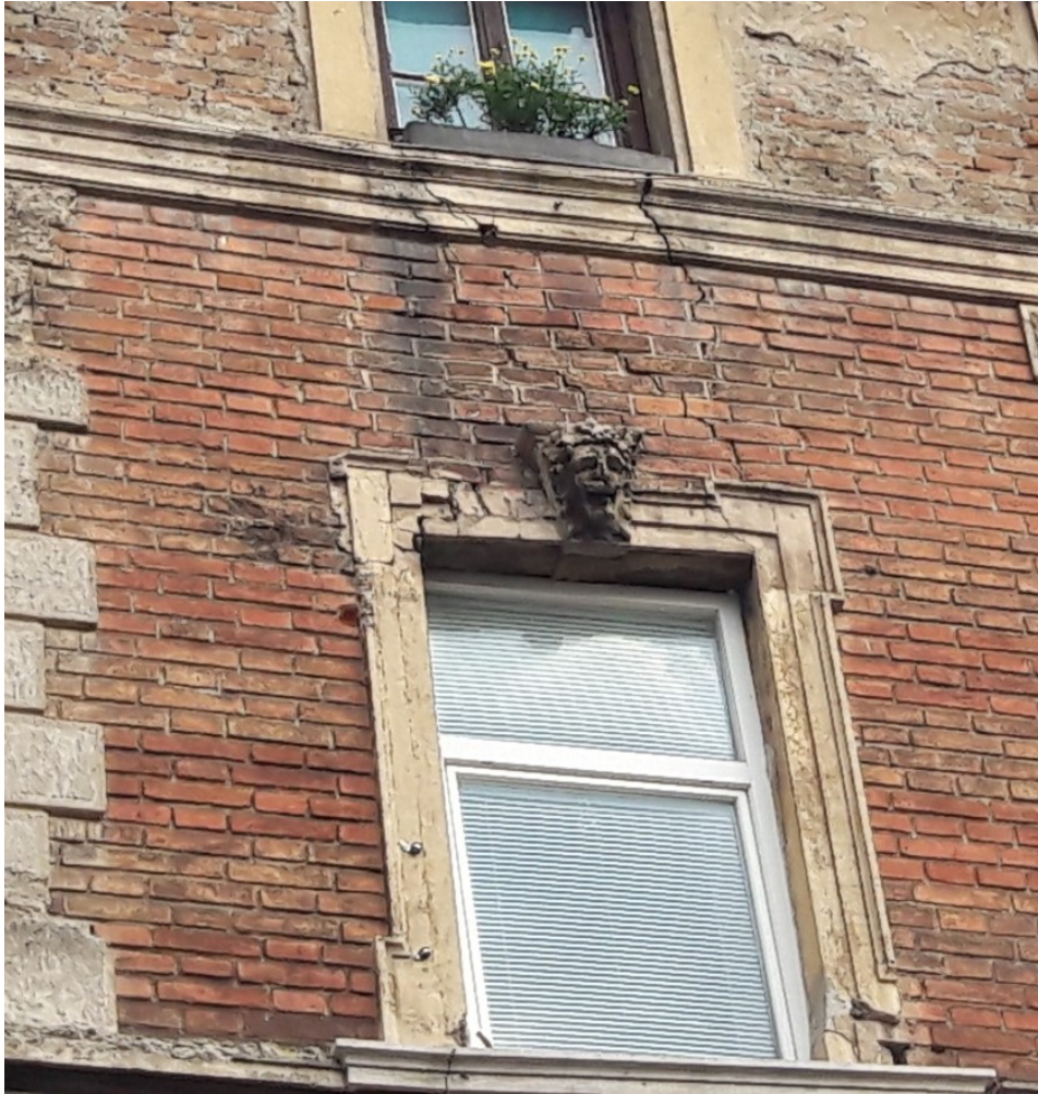
Slika 35. Pukotine i deformacija zida na zapadnom pročelju
