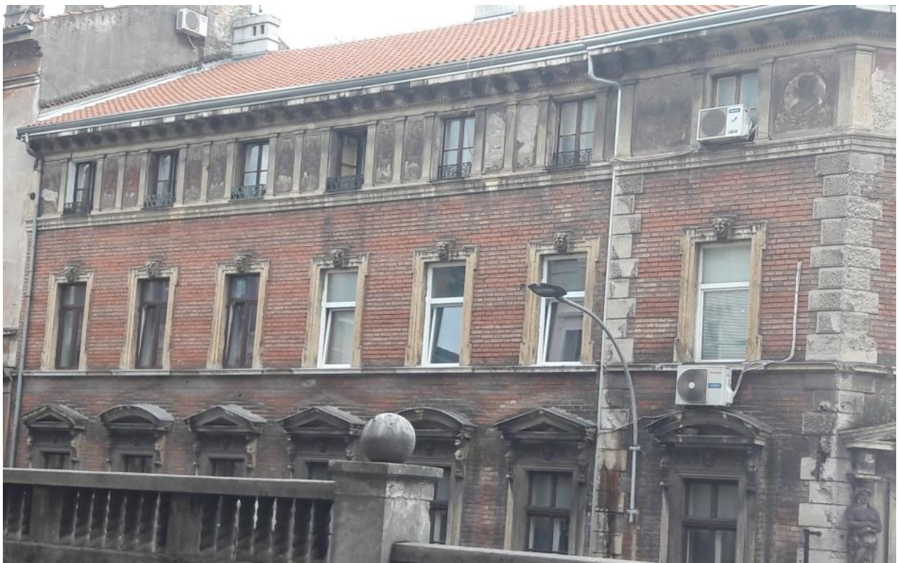
Slika 44. Sjeverno pročelje: crne kore – zahvaćene i slikane dekoracije; novi krov palače
