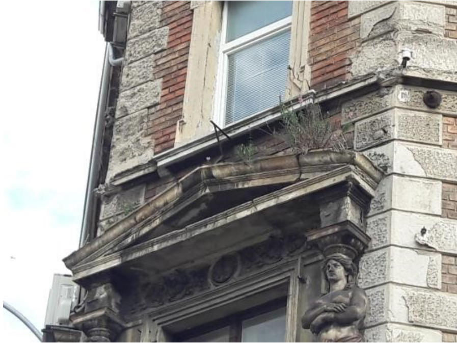
Slika 38. Vegetacija i crne kore (na dekorativnim elementima) na sjevernom ugaonom pročelju
