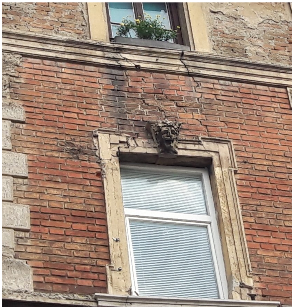
Slika 35. Pukotine i deformacija zida na zapadnom pročelju
