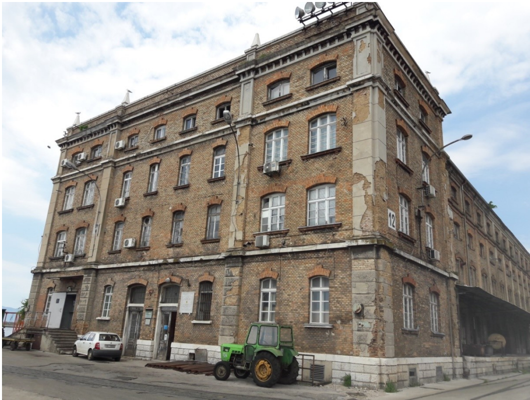
Slika 47. Istočno pročelje skladišta: gubitak materijala
