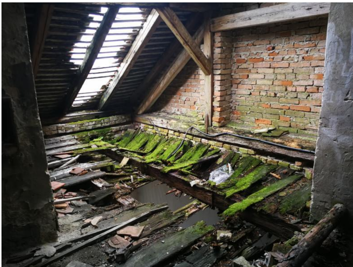
Slika 2. Uništen krov i tavanski pod na jednom od objekata, uzrokovano prokišnjavanjem i nemarom
