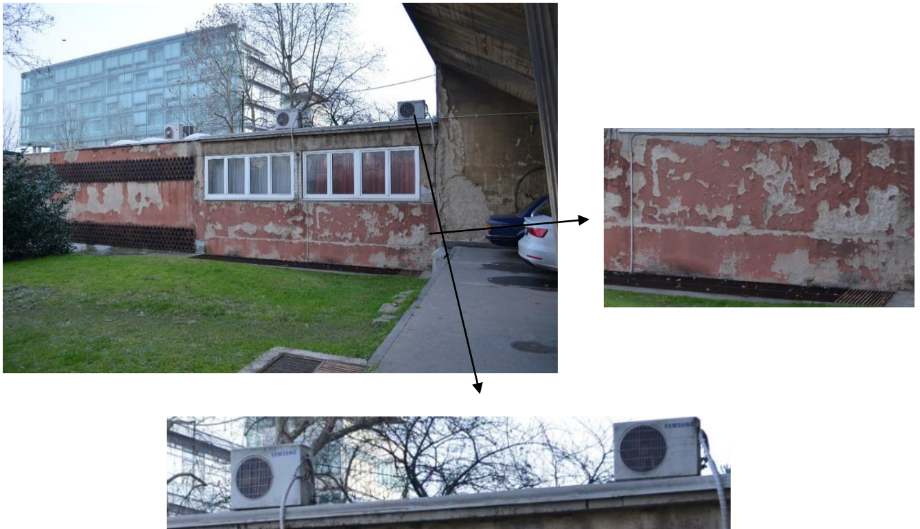
Slika 21. Detalj začelja stambene zgrade Drage Galića, Ulica grada Vukovara 43-43a 246
