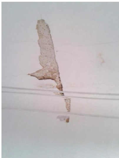
Slika 30. Oštećenje stropa uzrokovano vlagom u sobi pored središnje prostorije kata
