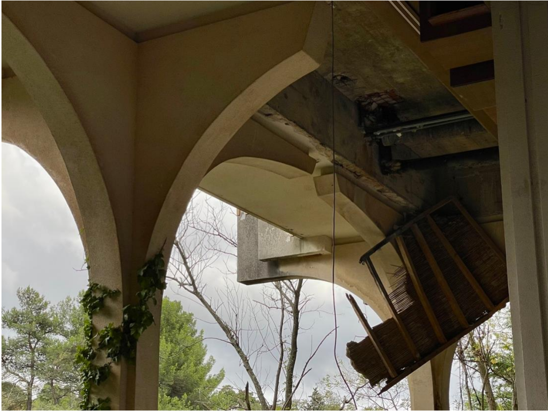
Sl. 9. Propadanje elemenata sa stropa kod ulaznog dijela
