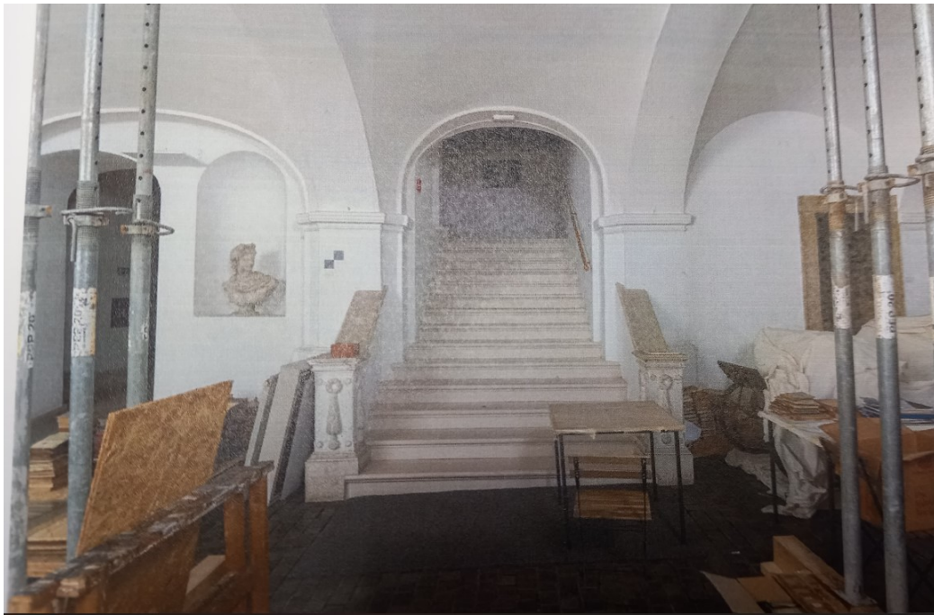
Slika 28. Ulazna veža prizemlja nakon potresa
