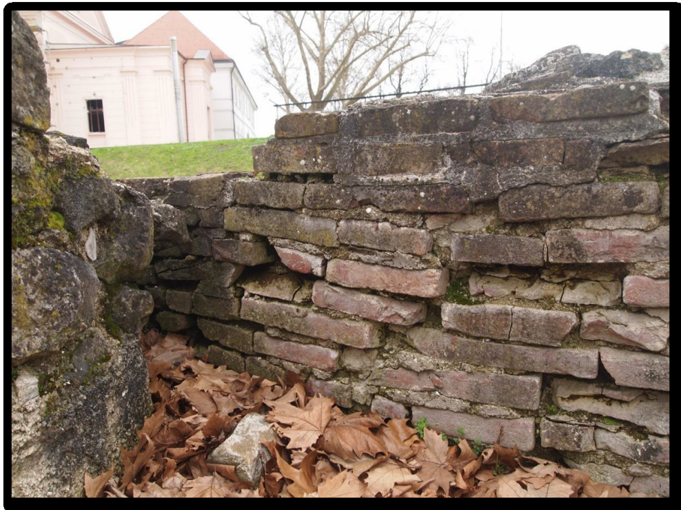
27 – oštećenja JI zida ugaone kule; stanje u ožujku 2024. (snimio: F. Jajčinović)
