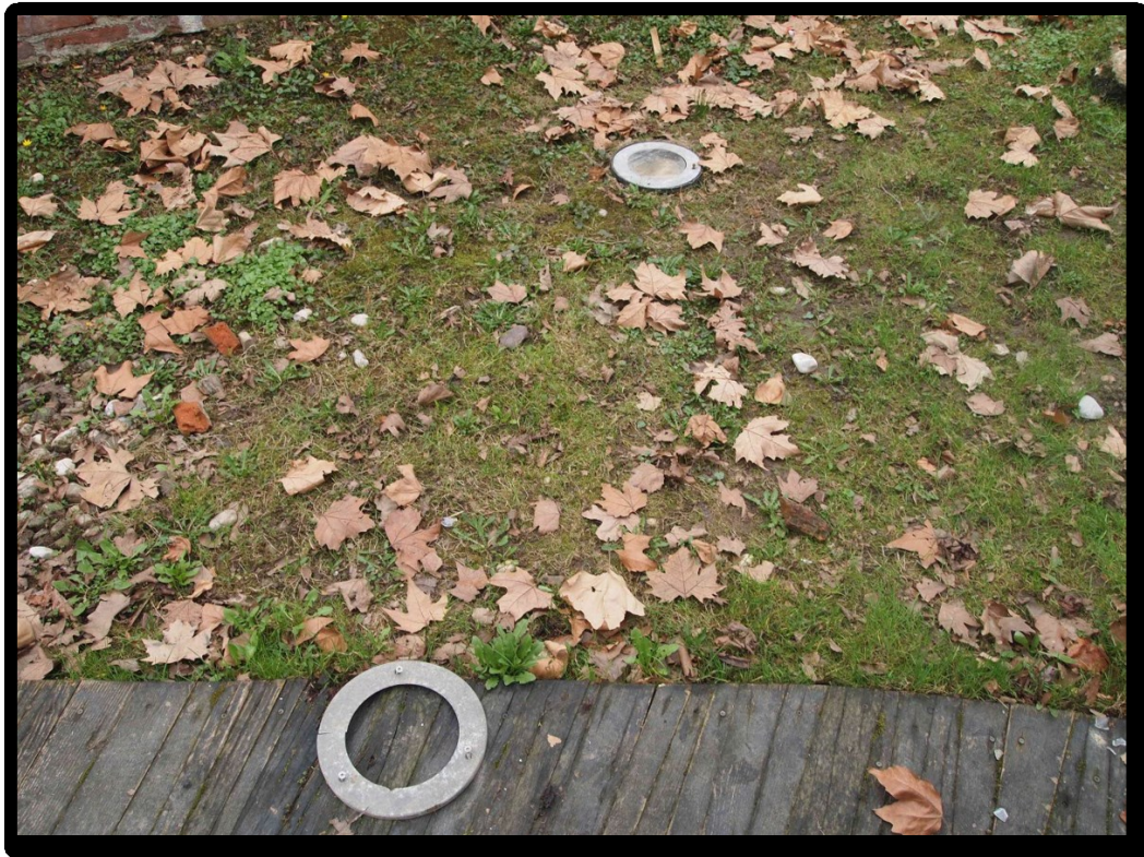
33 – rasvjetne lampe u hodnoj površini; stanje u ožujku 2024. (snimio: F. Jajčinović)
