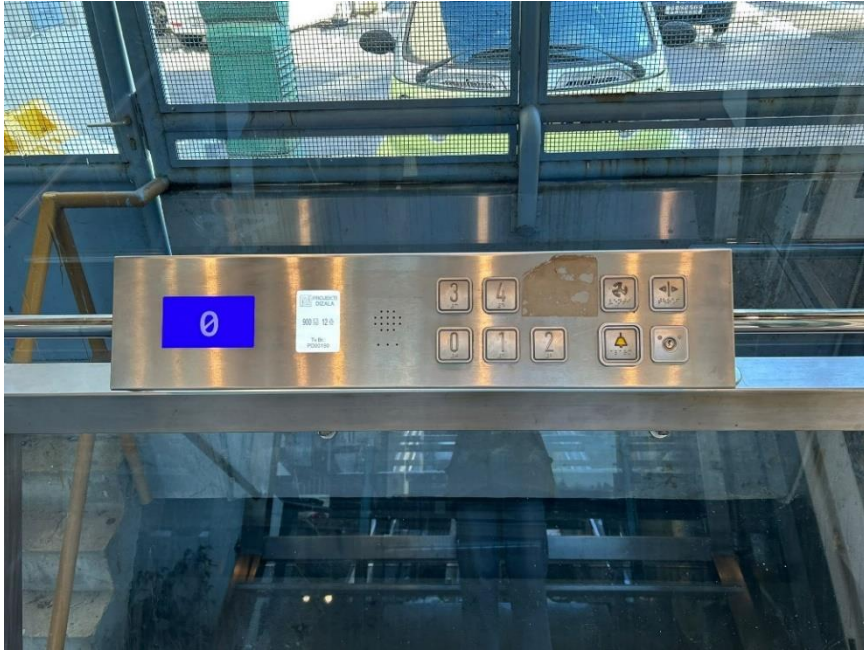
Sl. 24. Upravljačka ploča uspinjače (autorska fotografija, 2024)
