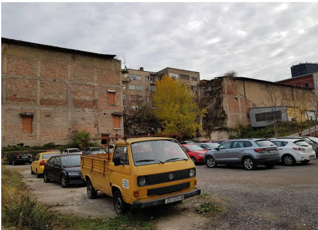
Fotografija 4: Urušeni dio dvorišne zgrade (2018.g), Izvor:Autor
