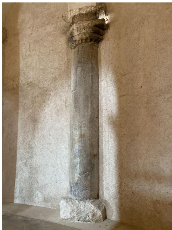
Slika 62. Desni stup s kapitelom zazidanog dvostrukog prolaza na galeriji rotunde Sv. Donata. Foto: Hana Buntak
