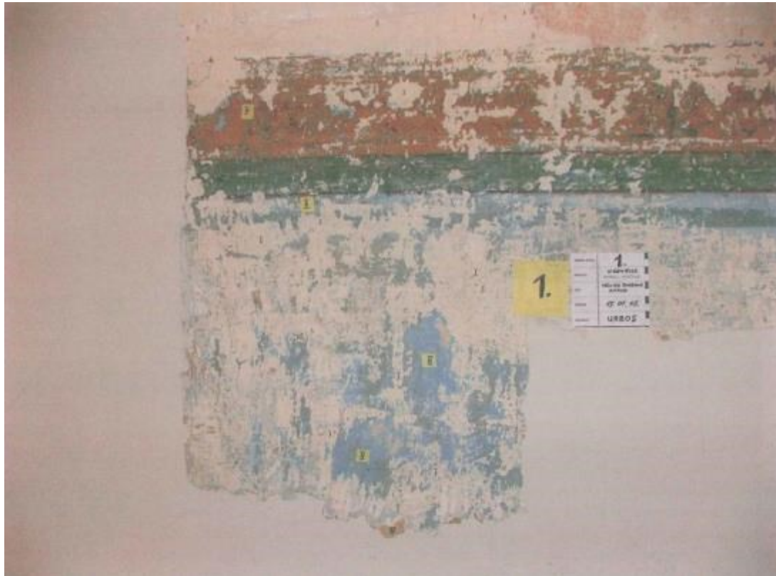
Slika 19: Sonda otvorena na zapadnom zidu velike hale u prizemlju dvorca, a u kojoj se može vidjeti stanje oslika i bojnih slojeva
