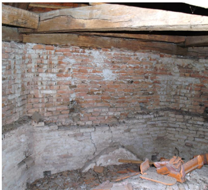
Slika 6 Crkva sv. Lovre, tavan s vidljivim strukturama povišenja zidova svetišta i ostatcima gotičkog svoda. Snimila 2010. Marijana Korunek 335 (Marijana Korunek, Branka Marcuiš, Josip Kovač, »Kapela i Trg sv. Lovre u Cirkovljanu«, u: Godišnjak Hrvatskog restauratorskog zavoda 6 (2015), str. 57)
