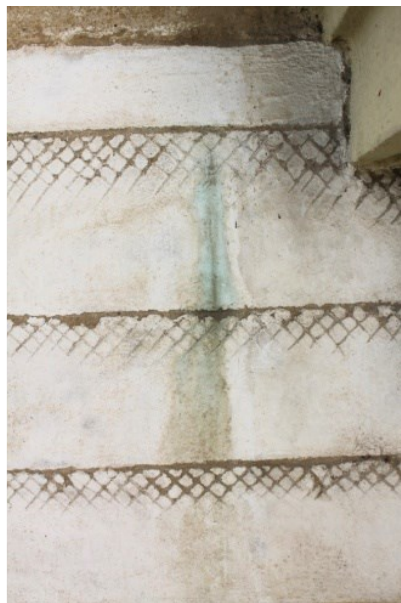
Slika 32. Zeleno obojenje od oksidacije metala
