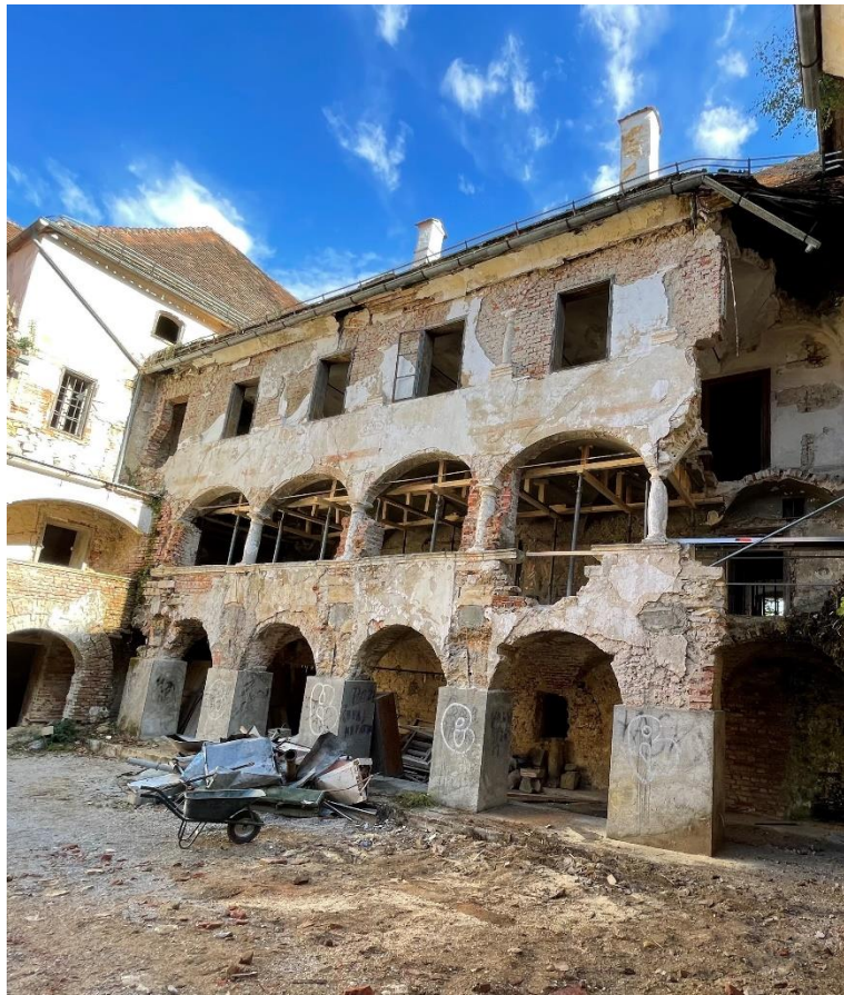
Slika 26. Oštećenje trijema, sjeveroistočno pročelje
