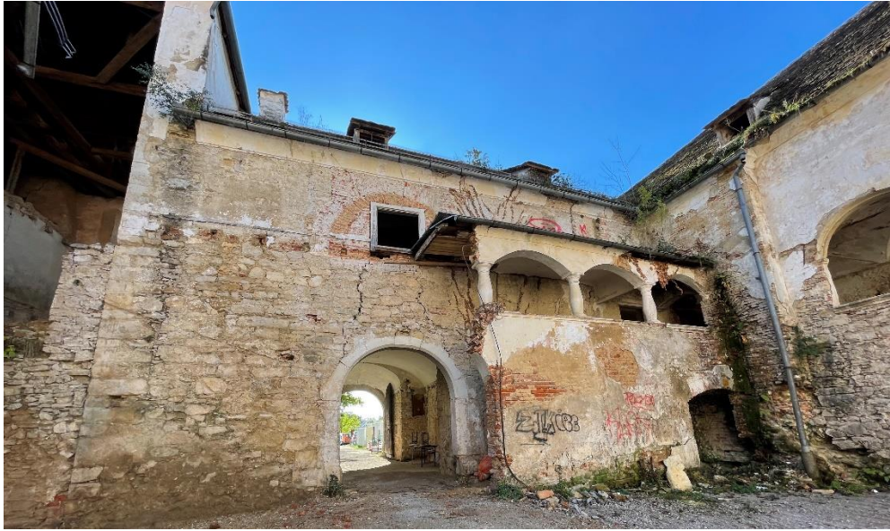
Slika 27. Oštećenja jugoistočnog dvorišnog pročelja
