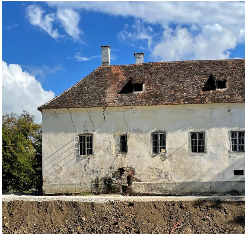
Slika 25. Detalj oštećenja, jugozapadno pročelje
