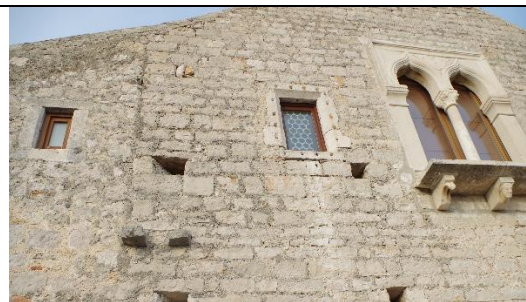
sl.28. Ostavljeno slijeganje krovišta
