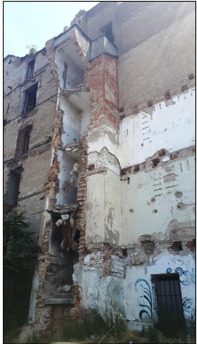
Sl. 24. Ostaci zida zgrade mlina između transmisije i skladišta brašna, pogled sa zapadne strane, 2019. godine (Foto: Monija Škriljevečki)
