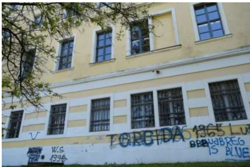
Slika 24. Glavna zgrada, dvorac Batthyány, vandalističko uništavanje pročelja sjevernog krila zgrade
