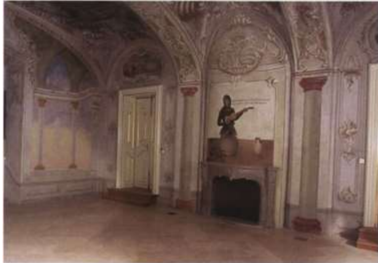
Slika 50. Zapadna bočna zgrada sklopa dvorca Batthyány, pogled na jugoistočni dio velike dvorane nakon radova
