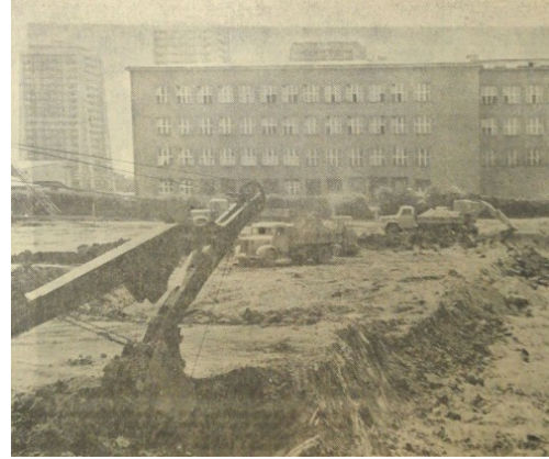
Slika 21. Postavljanje temelja za poslovni toranj. Fotografirano u pravcu juga. U pozadini vidi se zgrada Ženske realne gimnazije sestara milosrdnica – danas Učiteljski fakultet na Savskoj cesti (projekt napravio Zvonimir Vrkljan, sagrađena 1937. – 1939.) 136
