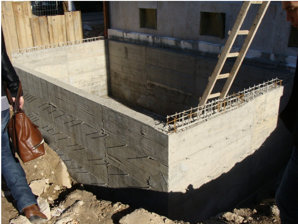
sl. 131. „Bazen“ za klimatizacijske jedinice Prirodoslovnog muzeja u Metkoviću, snimljen u procesu građenja. Fotografirano tijekom obnove zgrade koja je trajala od 2008. do 2015. godine
