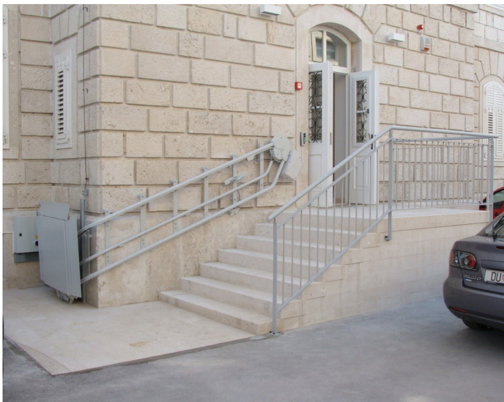
sl. 92. Prilaz glavnom ulazu Prirodoslovnog muzeja i Gradske knjižnice u Metkoviću, pogled sa sjeverozapadne strane na sjeverni dio ulaznog stepeništa. Osim njega, na slici je vidljiva i kosa stubišna platforma za osobe u invalidskim kolicima, ograda s rukohvatom te dvokrilna ulazna vrata. Fotografirano pri kraju ili nedugo nakon završetka obnove koja je trajala od 2008. do 2015.
