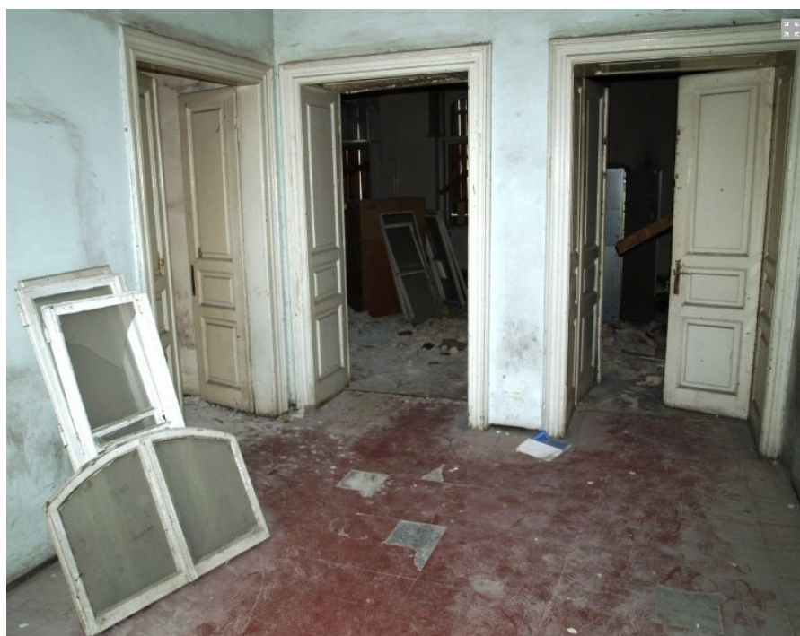
sl. 122. Drvena dvokrilna vrata, koja su se nalazila na ulazima u unutrašnjosti zgrade bivše uprave i stanovanja metkovske duhanske stanice, danas Prirodoslovnog muzeja i Gradske knjižnice. Fotografirano tijekom obnove zgrade koja je trajala od 2008. do 2015. godine
