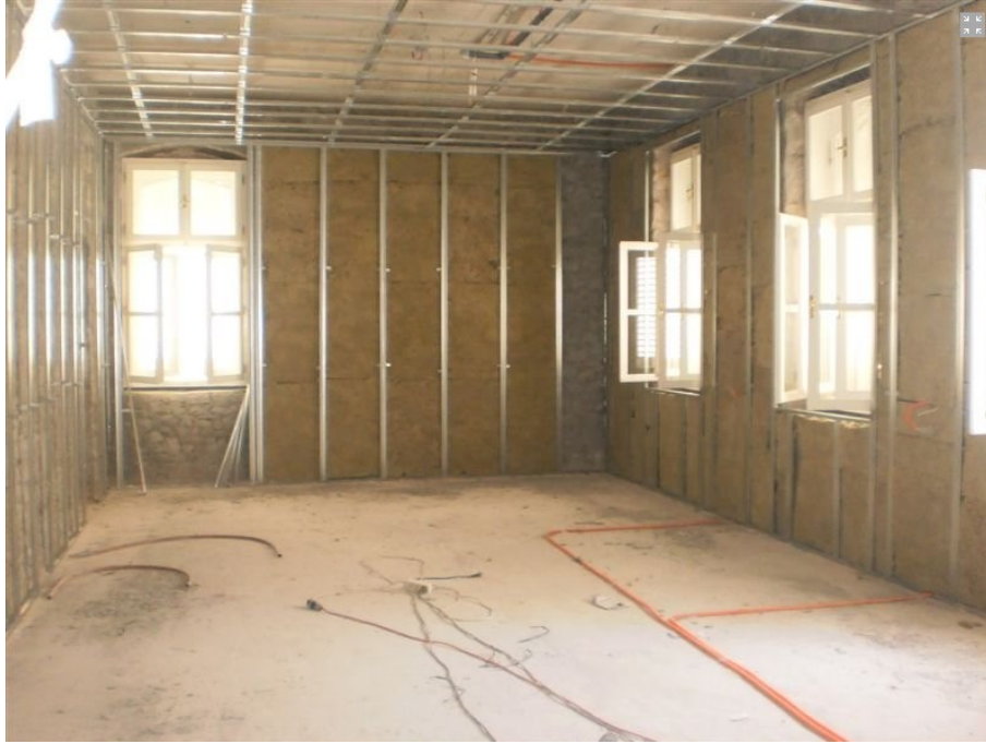
sl. 87. Aluminijska podkonstrukcija montirana na unutrašnje strane vanjskih zidove prvog kata zgrade Prirodoslovnog muzeja i Gradske knjižnice, na koje će se postaviti mineralna vuna. Fotografirano tijekom obnove zgrade koja je trajala od 2008. do 2015. godine
